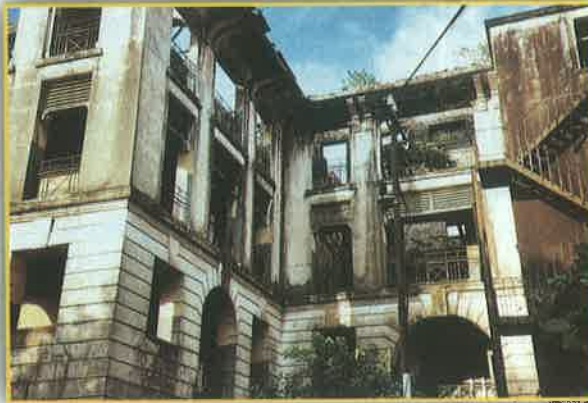
لم تتم إعادة بناء المباني الحكومية التي دمرت أثناء الحرب
